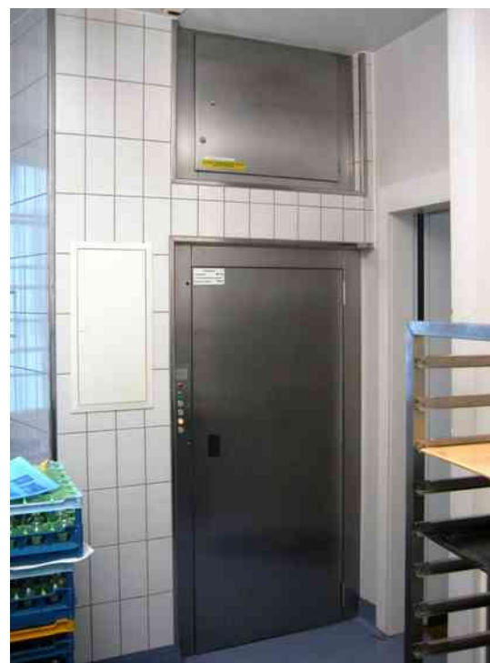
Maschinenraum über der obersten Haltestelle.
